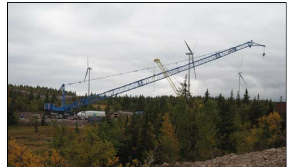
Kran som används vid monteringen av vindkraftverken på Bliekevare, i Dorotea kommun.
